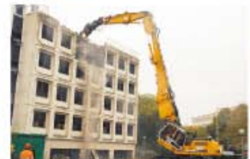
Démolir pour reconstruire plus adapté au monde économique, c'est l'objectif pour continuer d'attirer les entreprises. En octobre, la première opération du genre débute dans la zone d'activités du Pas du Lac.
